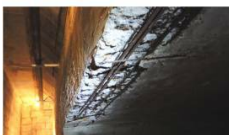
Bilde 3: Korrosjon i 10' bassengkanten (2018). Avviket består av tykke korroderte armerings Betongskader svømmehall.png
