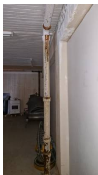
Utett avløpsrør i garasje.jpg
